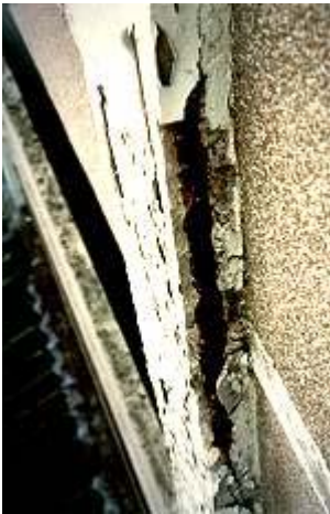
Risse im Beton und schalenförmige Abplatzungen
