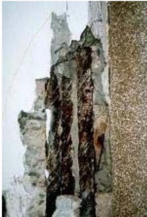
Korrosion der Bewehrungsstähle
