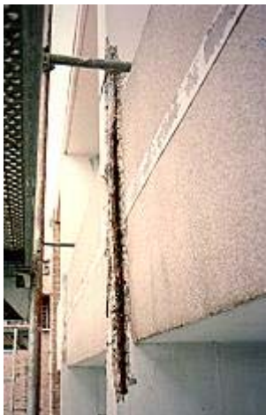
Schadstellen an der Fassade des Internatsgebäudes
