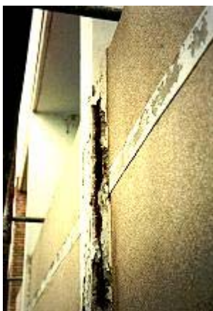
Freiliegende stark korrodierende Bewehrungsstäbe
