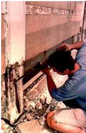
Freistemmen des rostenden Bewehrungsstahls
