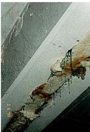
Austritt des Polyacrylatgels an der verdämmten Dehnungsfuge
