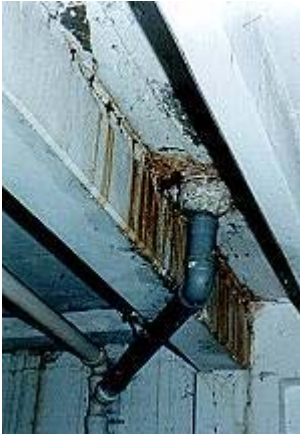
Wasseraustritt durch die Fuge in der Stahlbetondecke und an der Rohrdurchführung der Dachentwässerung
