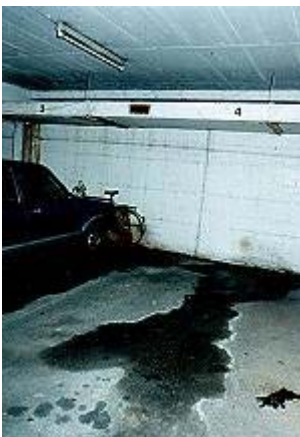
Wasserstände in der Tiefgarage
