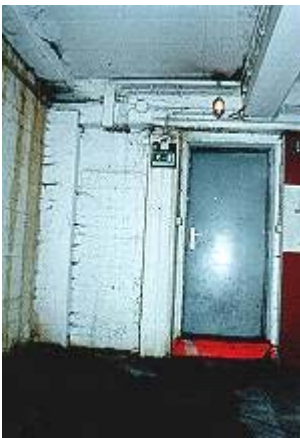
Durch Bauteifugen eindringendes Oberflächenwasser
