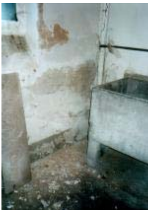
Ausblühungen und Abplatzungen an den Kellerwänden
