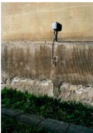
Großflächige Absprengungen im Sockelbereich der Außenwände
