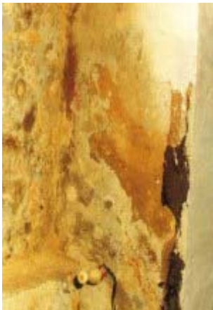
Salzabsprengungen an der Innenwand
