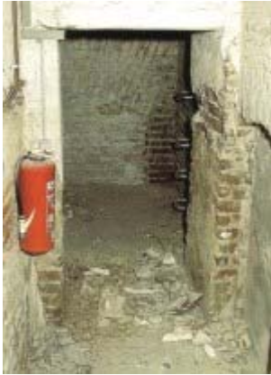
Mauerwerk mit Feuchteschäden
